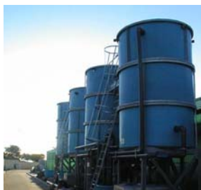
Biofiltry jsou významným zlepšením využití vody včetně redukce jejího zatížení živinami.
