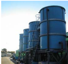
Les filtres biologiques améliorent l'utilisation faite de l'eau et réduisent les rejets en substances nutritives
